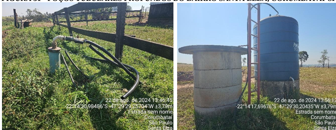
FIGURA 31 - POÇOS TUBULARES PROFUNDOS DO BAIRRO SANTA ELZA, CORUMBATAÍ-SP.
