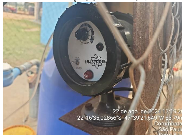
Figura 44 - DOSADOR DE CLORO DA MINERAÇÃO SERRA AZUL.
