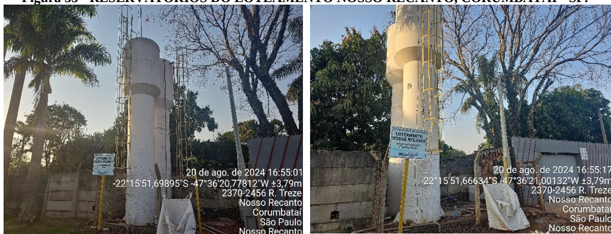
Figura 35 - RESERVATÓRIOS DO LOTEAMENTO NOSSO RECANTO, CORUMBATAÍ - SP.
