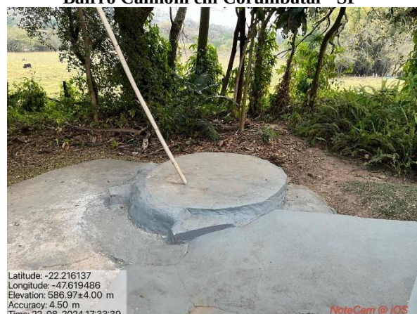
FIGURA 51 – Fossa séptica em propriedade no Bairro Canhoni em Corumbataí - SP
