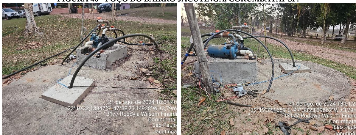
FIGURA 40 - POÇO DO BAIRRO JACUTINGA, CORUMBATAÍ-SP.
