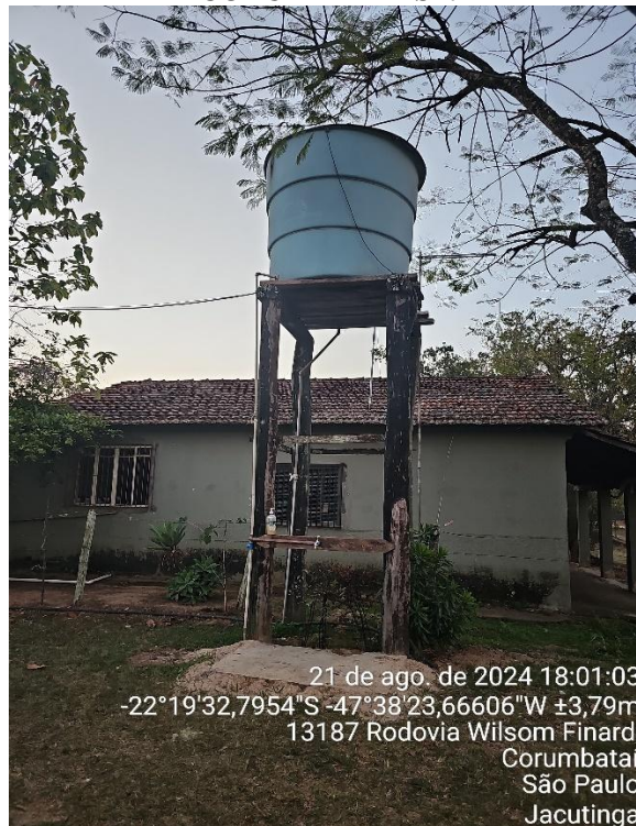
FIGURA 14 - RESERVATÓRIO DE ÁGUA DE UMA PROPRIEDADE EM JACUTINGA, CORUMBATAÍ-SP.
