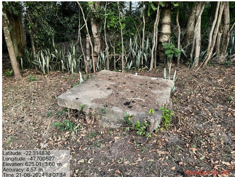
FIGURA 22 –Tampa de fossa séptica no bairro Itapé em Corumbataí - SP
