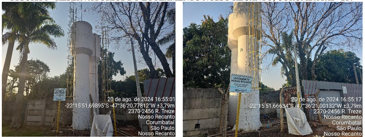
FIGURA 8 - RESERVATÓRIOS DO LOTEAMENTO NOSSO RECANTO, CORUMBATAÍ - SP.
