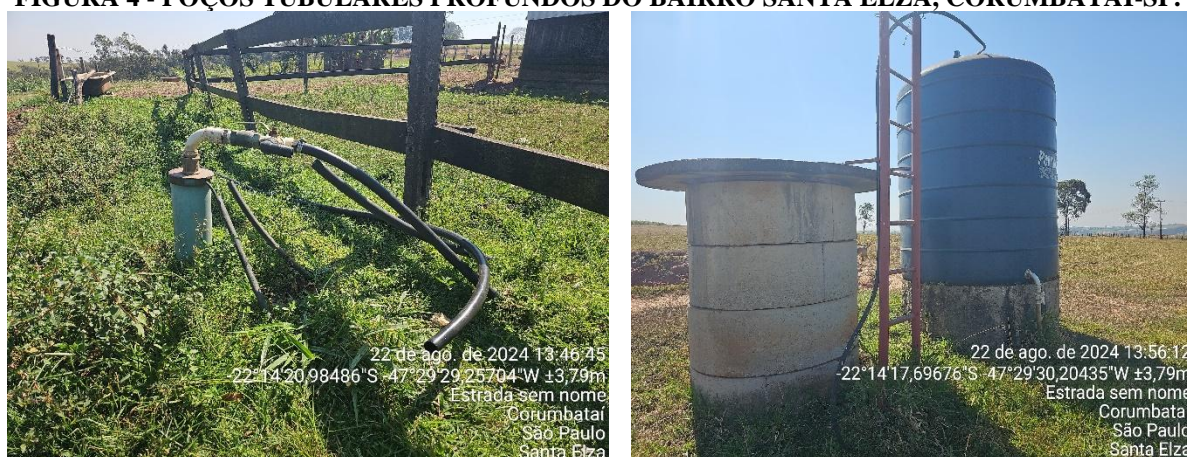
FIGURA 4 - POÇOS TUBULARES PROFUNDOS DO BAIRRO SANTA ELZA, CORUMBATAÍ-SP.
