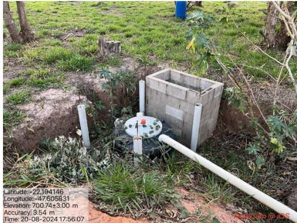
FIGURA 20 – Fossa séptica em propriedade no Loteamento de chácaras em Corumbataí - SP
