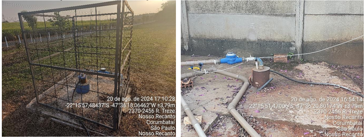
FIGURA 7 - POÇO 1 (ENTRADA) E POÇO 2, LOTEAMENTO NOSSO RECANTO, CORUMBATAÍ.
