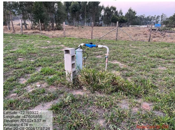
FIGURA 12 - POÇO EM PROPRIEDADE NO LOTEAMENTO DE CHÁCARAS EM CORUMBATAÍ - SP
